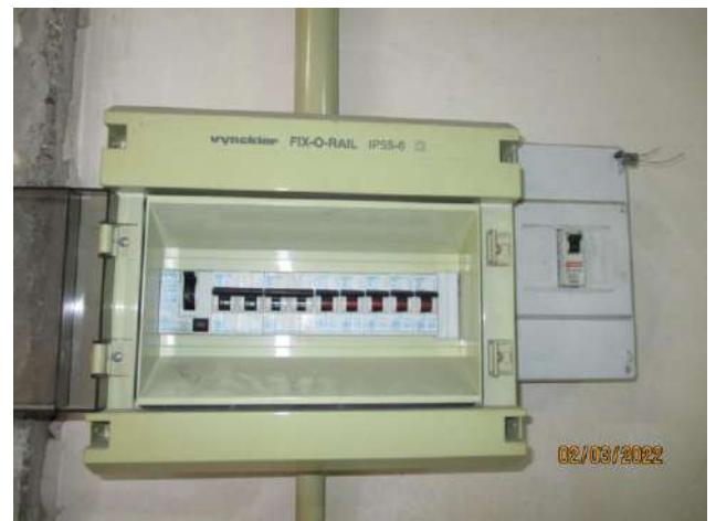
Detall quadre elèctric
