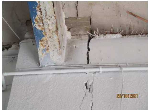
Fissures en murs i sostremorts
