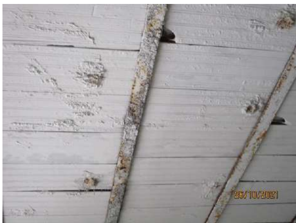
Signes d'oxidació en elements metàl·lics
