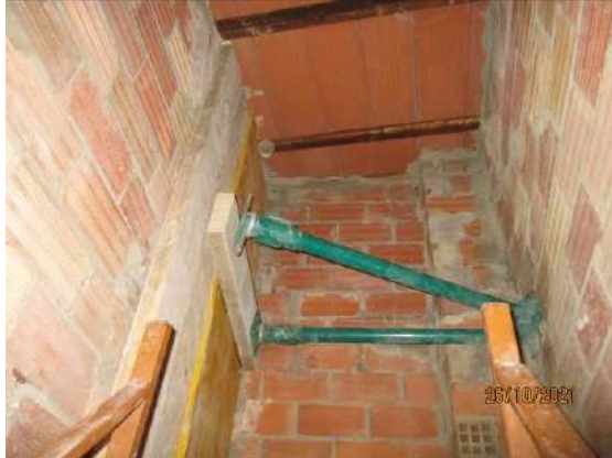
Accés a terrassa apuntalat
