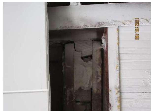
Reforços metàl·lics sense suport i oxidats
